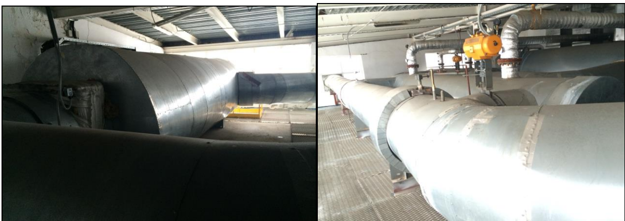
Теплообменники уходящих газов
