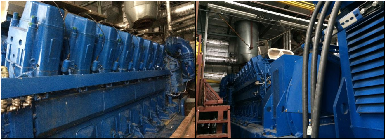
Газо - поршневая установка MWM Deutz 2032 V16
